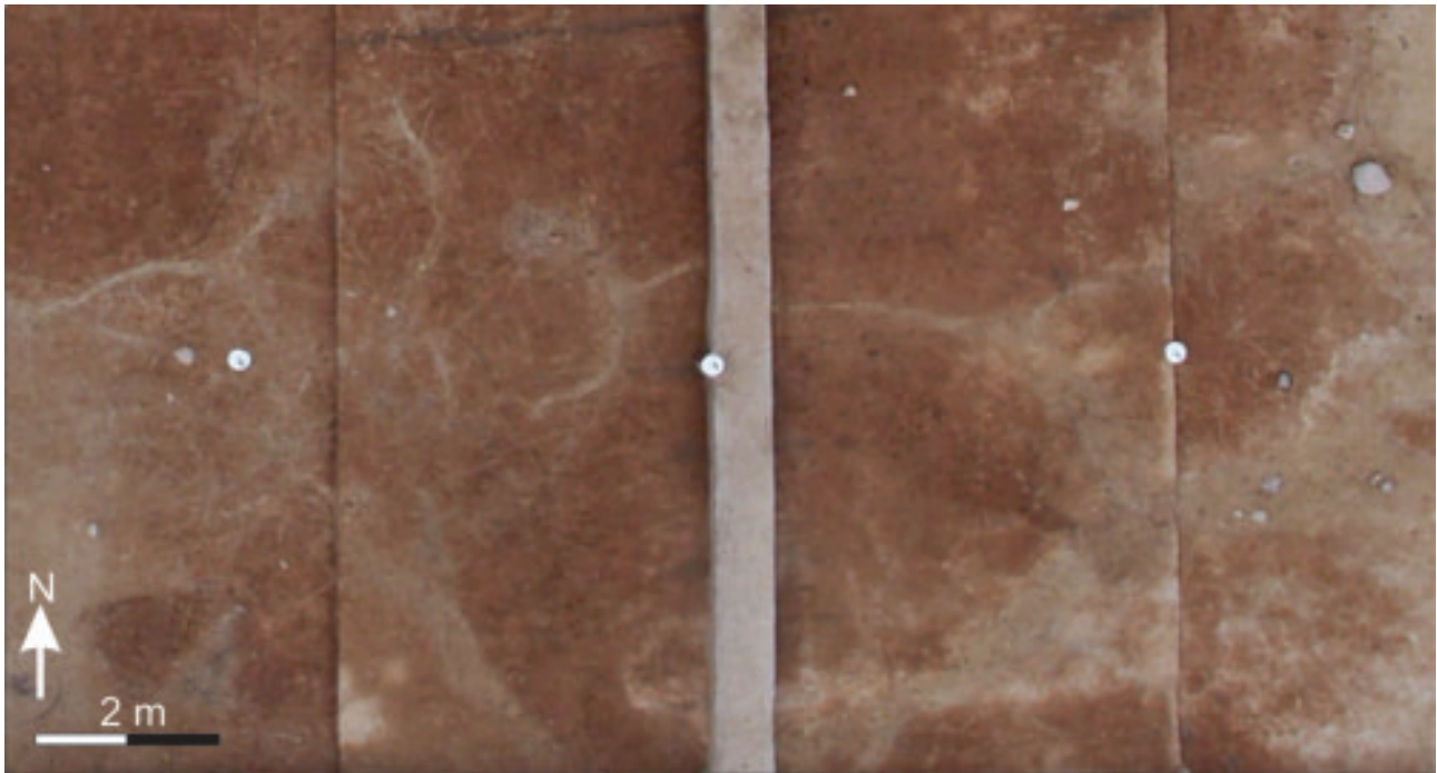
Ryc. 42. Układ poligonalny szczelin kontrakcyjnych w widoku planarnym.
