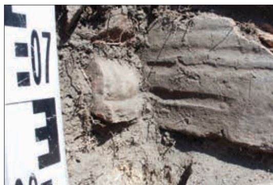
Ryc. 7. Zielona Góra, stan. 31, woj. lubuskie. Kształtka ceramiczna w jednym z filarów muru filarowo-łękowego. Fot. B. Gruszka
