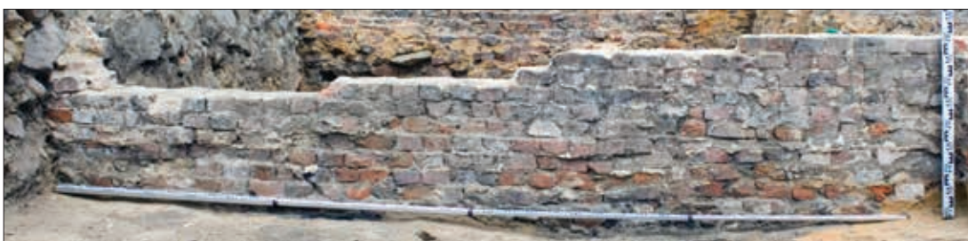
Ryc. 83. Zielona Góra, stan.31, woj. lubuskie. Wykop 5, lico zachodnie muru granicznego (j.s. 105). Fot. B. Gruszka
