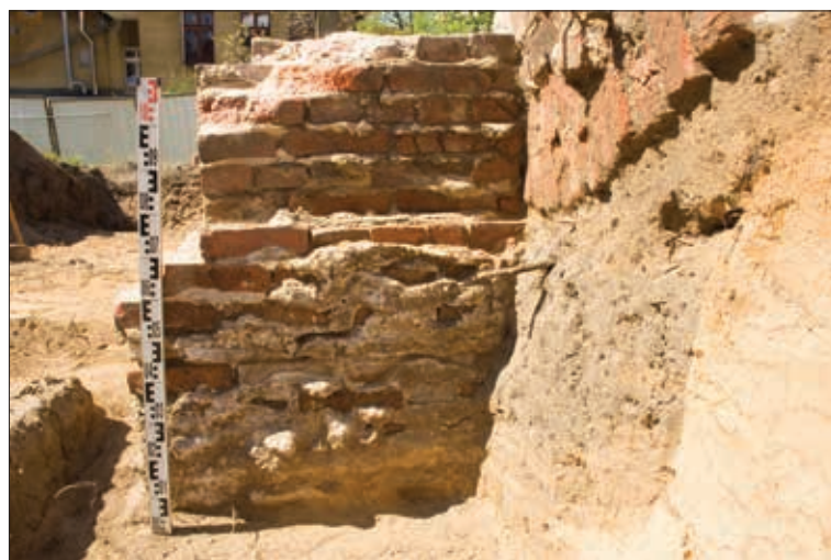
Ryc. 78. Zielona Góra, stan.31, woj. lubuskie. Wykop 1A, lico wschodnie fundamentu przypory. Fot. B. Gruszka
