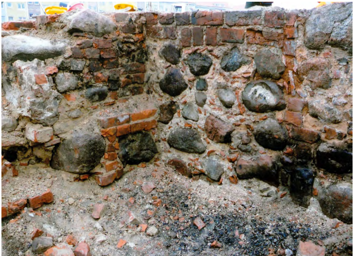
Ryc. 22. Stargard, Stare Miasto, kwartał IX. Narożnik N-W piwnicy kamienicy Targ Drzewny 20. Widok od S-E. Fot. T. Balcerzak
