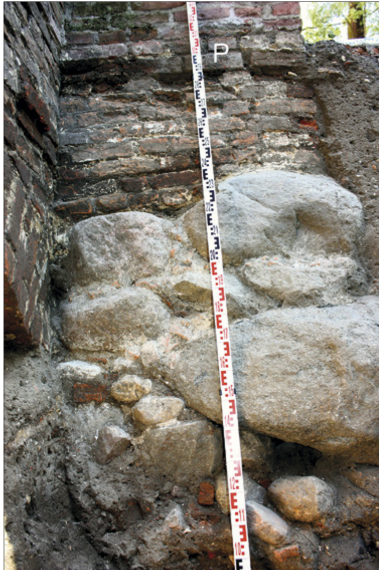
Ryc. 50. Toruń (stan. 360), kościół św. Jakuba. Wykop W-16/15. Widok od zachodu na fundament wschodniej przypory P (nr 13) – zbliżenie. Fot. J. Struwe
