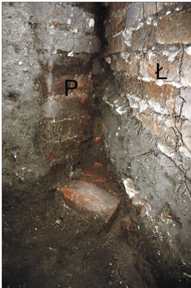
Ryc. 65. Toruń (stan. 360), kościół św. Jakuba. Wykop W-8/11. Łącznik – styk przekątniowej przypory P (po lewej) wschodniej ściany nawy południowej i fundamentu łącznika Ł (po prawej). Widoczne niedokładne murowanie fundamentu. Fot. J. Struwe
