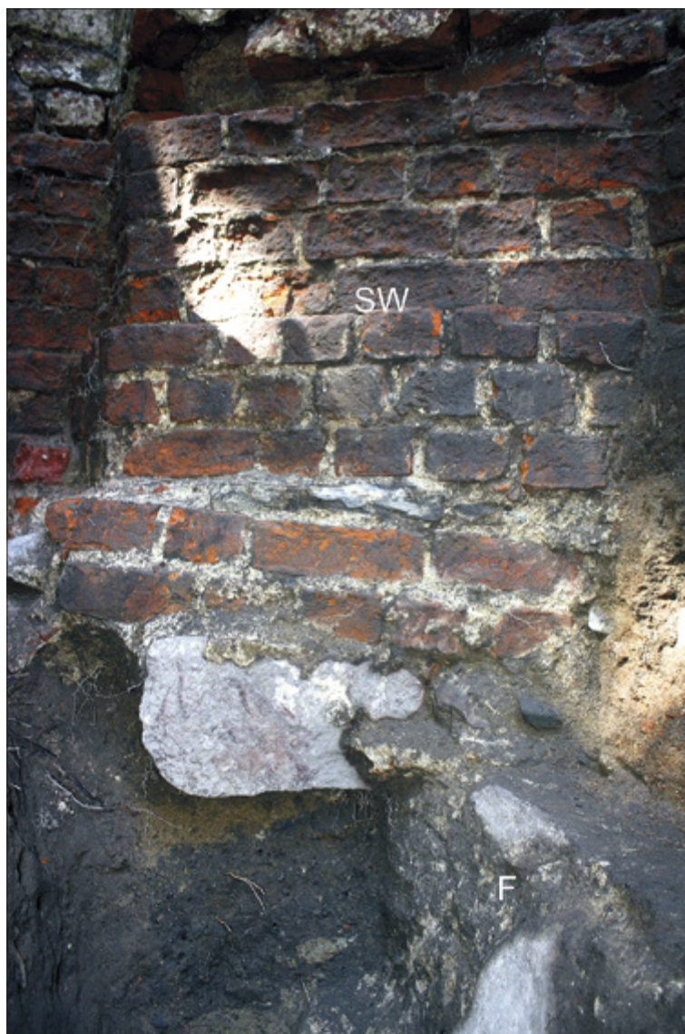
Ryc. 36. Toruń (stan. 360), kościół św. Jakuba. W-10B/12 – fundament wieżyczki schodowej (SW) na kamiennym fundamencie (F); zbliżenie. Fot. J. Struwe
