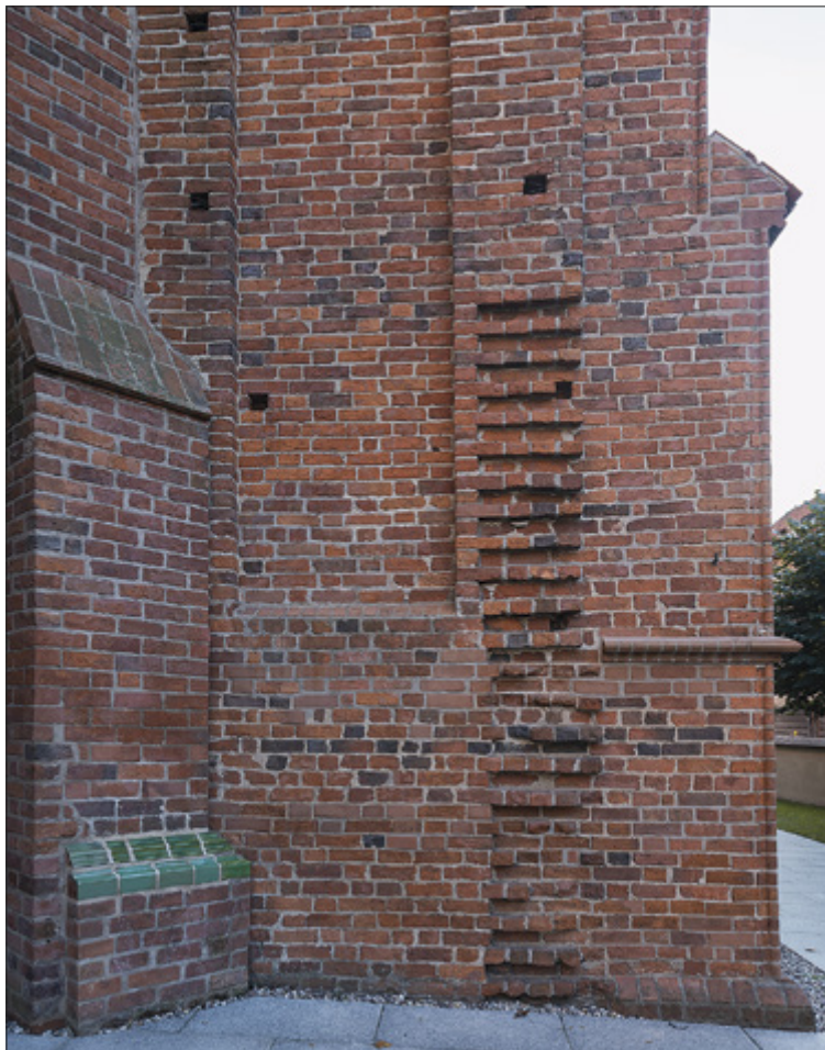
Ryc. 52. Toruń (stan. 360), kościół św. Jakuba. Strzępia widoczne na wschodniej ścianie nawy północnej, przy zakrystii. Fot. W. Ochotny
