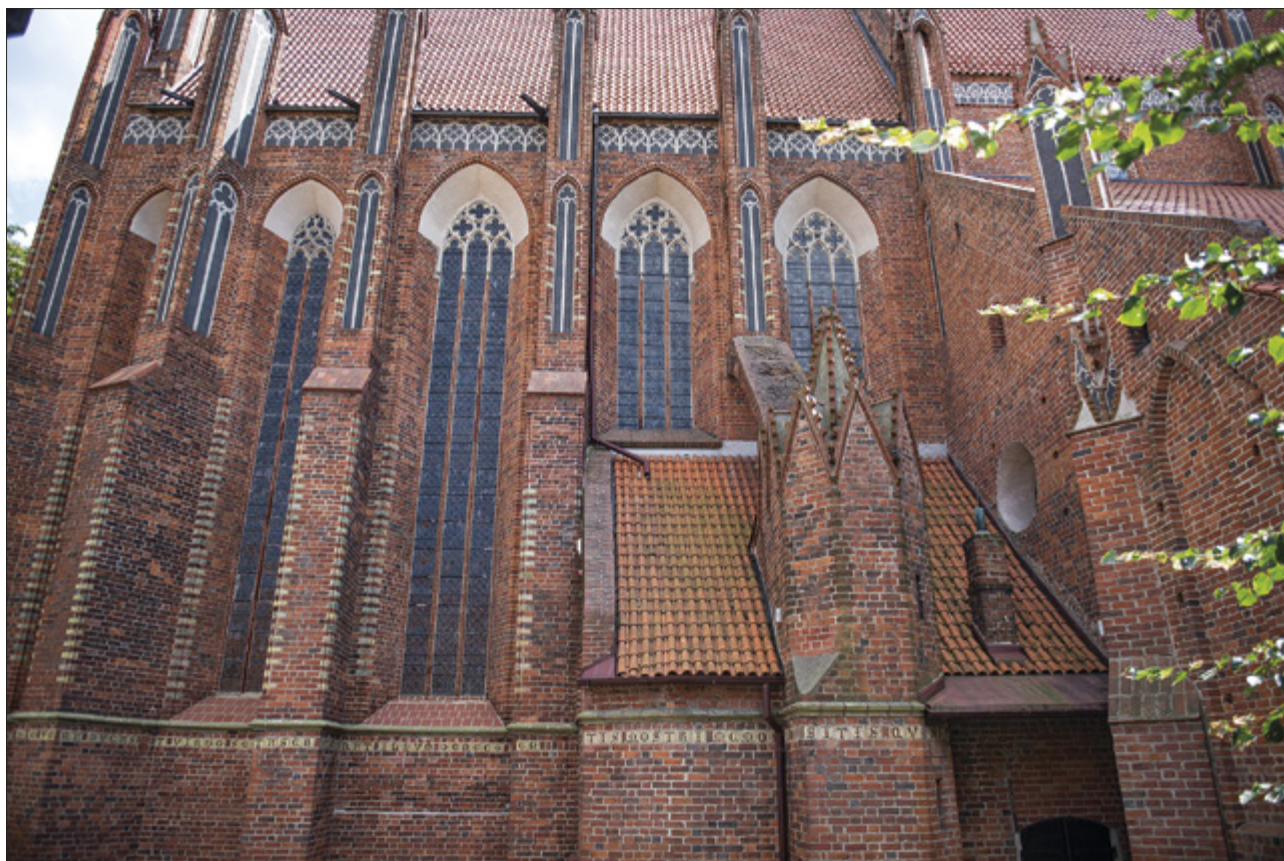
Ryc. 5. Toruń (stan. 360), kościół św. Jakuba. Bryła kościoła od północy. Widok na zakrystię z łukiem odporowym. Fot. W. Ochotny
