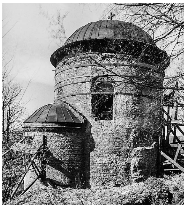
Il. 7.3.4 Rotunda z czterema obręczami podczas badań A. Kietlińskiej i remontu (fot. T. Kubisz) ¶ Rotunda with four clamping rings during the research by A. Kietlińska and the restoration (photo: T. Kubisz)
