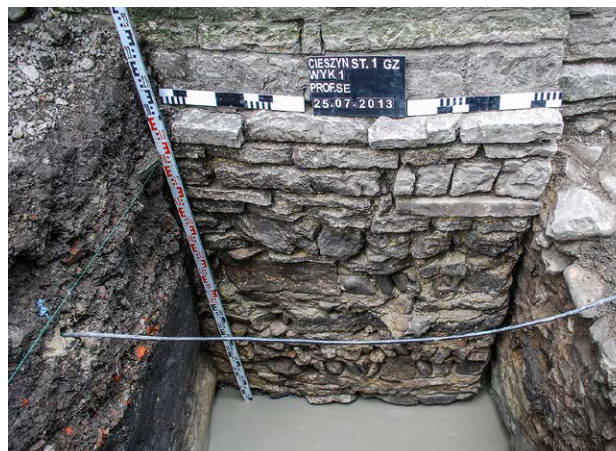
Il. 1.6 Wody podskórne (przypowierzchniowe) gromadzące się po opadach przy fundamentach rotundy – wykop 1 w 2013 r.; zachodnie lico fundamentu rotundy na odcinku klatki schodowej i muru 1 (fot. M. Piwko) ¶ Subsurface water (subsoil water) accumulated at the foundations of the rotunda after rainfall – trench no. 1 in 2013; western front part of the rotunda foundations in the section of the staircase and wall no. 1 (photo: M. Piwko)
