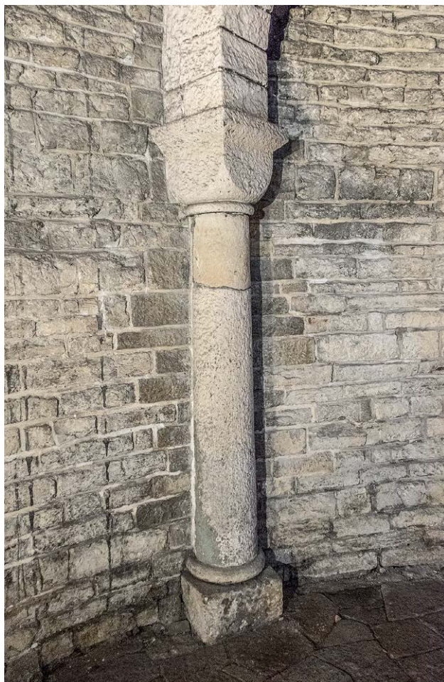
Il. 7.3.22 Półkolumna południowa z górnym, oryginalnym fragmentem trzonu (fot. T. Rodzińska-Choraży) ¶ Southern engaged column with an original upper part of the shaft (photo: T. Rodzińska-Choraży)
