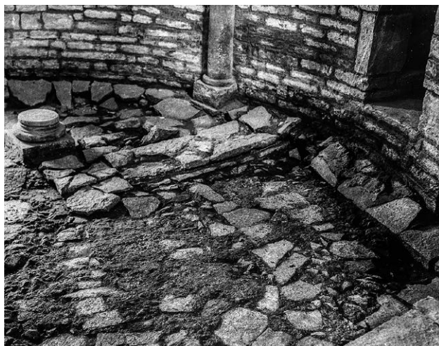
Il. 7.2.23 Pierwotny poziom użytkowy. Posadzka z płaskich płyt, w partii przy murze widoczne ich znaczące ugięcie (fot. A. Müller) ¶ Original floor paved with flat slabs bending by the wall (photo: A. Müller)
