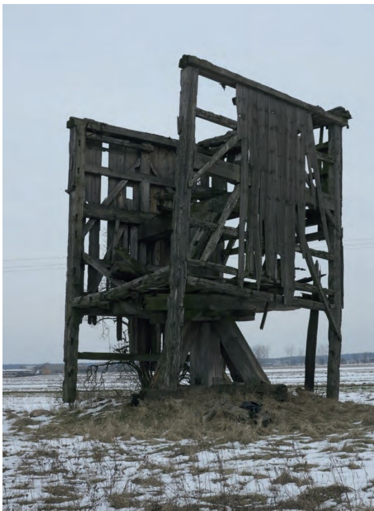
Pozostałości zabytkowego wiatraka, niegdyś elementu charakterystycznego polskich wsi i miasteczek, Fot. NID/T. Palacz
