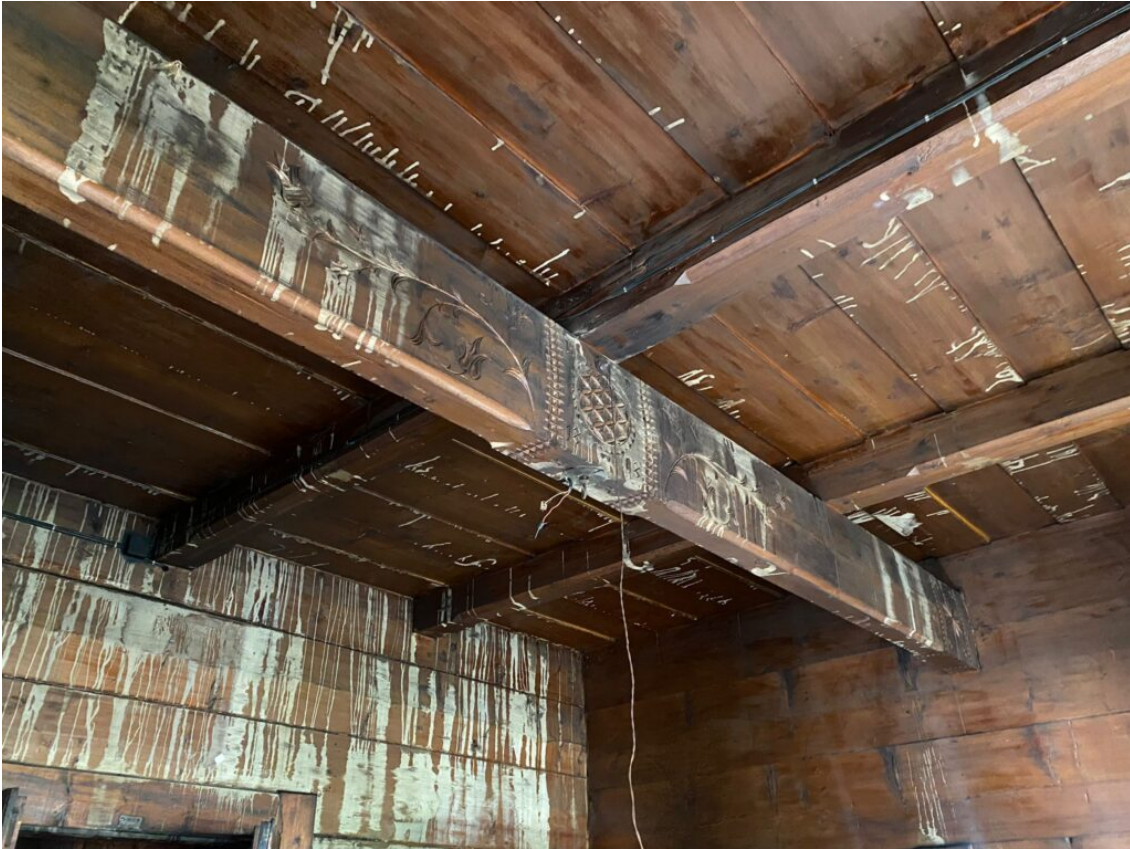
Pożar willi "Dom Doktora" przy ul. Witkiewicza w Zakopanem, aktualny stan zabytku, fot. NID/N. Skiepmo
